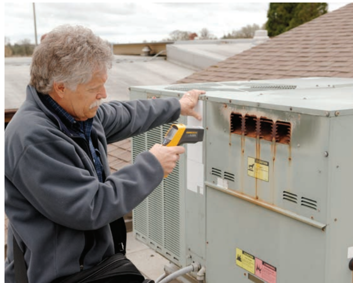
Testing av kjølesystem på et tak, med Fluke 561 IR-termometer
