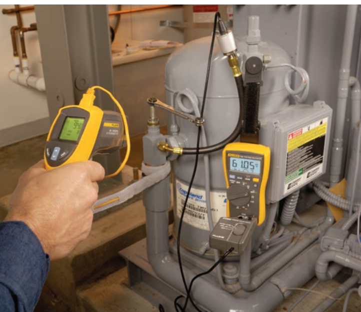
Måling av temperatur og sugetrykk for å beregne overheting
